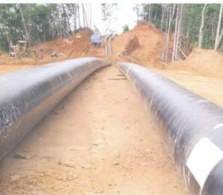
Transportadora de Gas del Perú S.A.
