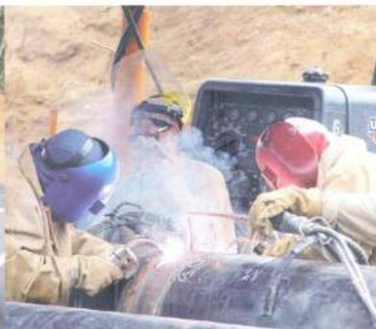
Transportadora de Gas del Perú S.A.
