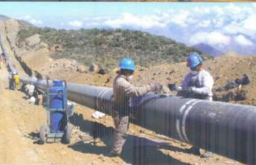
Transportadora de Gas del Perú S.A.
