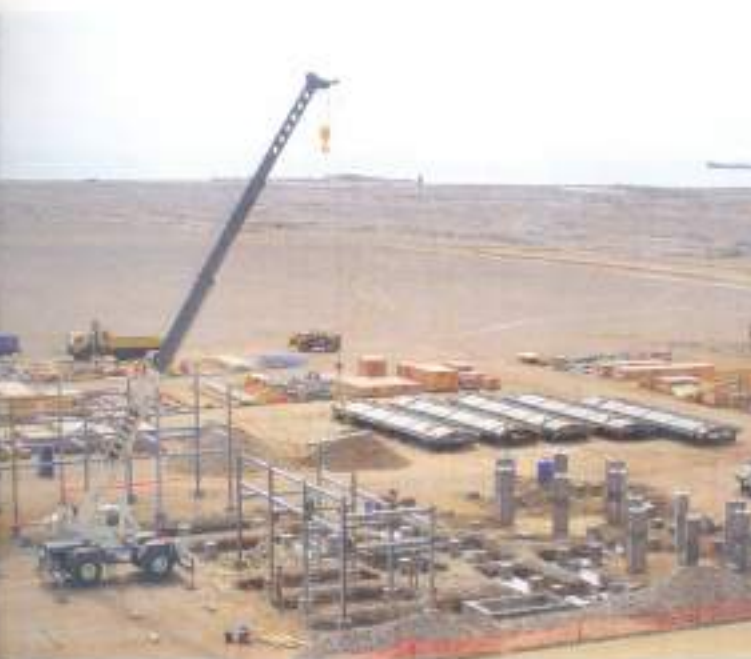
Transportadora de Gas del Perú S.A
